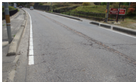
破損が進行した既設舗装
