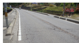
破損が進行した既設舗装
