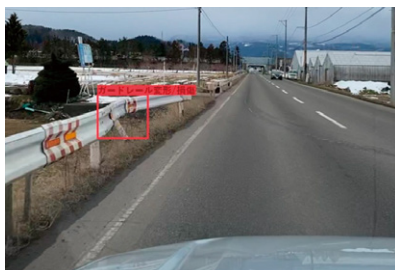
ガードレールの損傷
