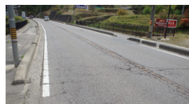
破損が進行した既設舗装
