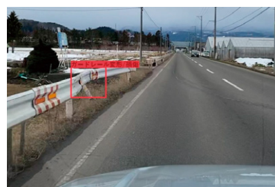
ガードレールの損傷
