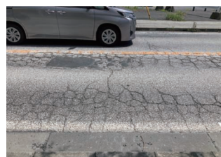
舗装のひび割れ
