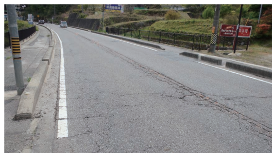
破損が進行した既設舗装
