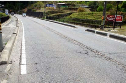
破損が進行した既設舗装
