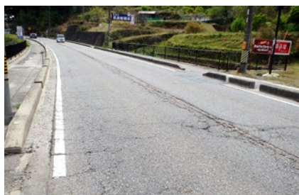
破損が進行した既設舗装
